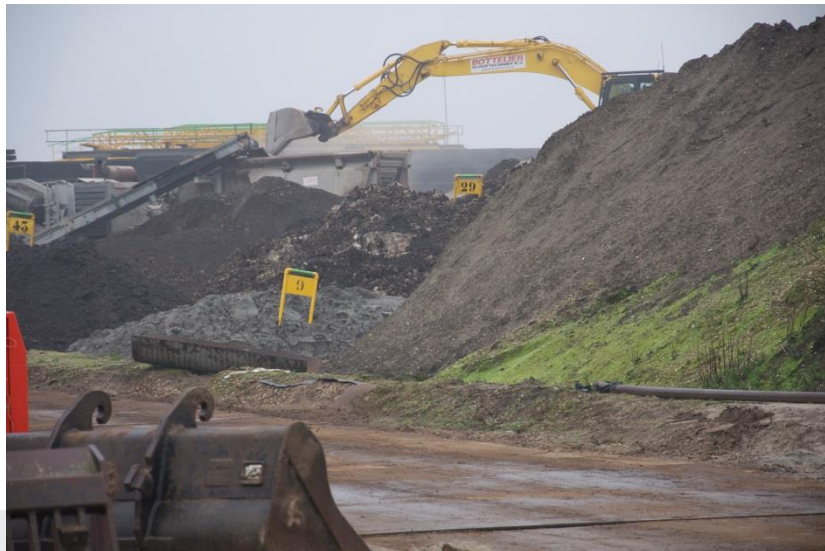
Foto: Risico op energieoverslag.
